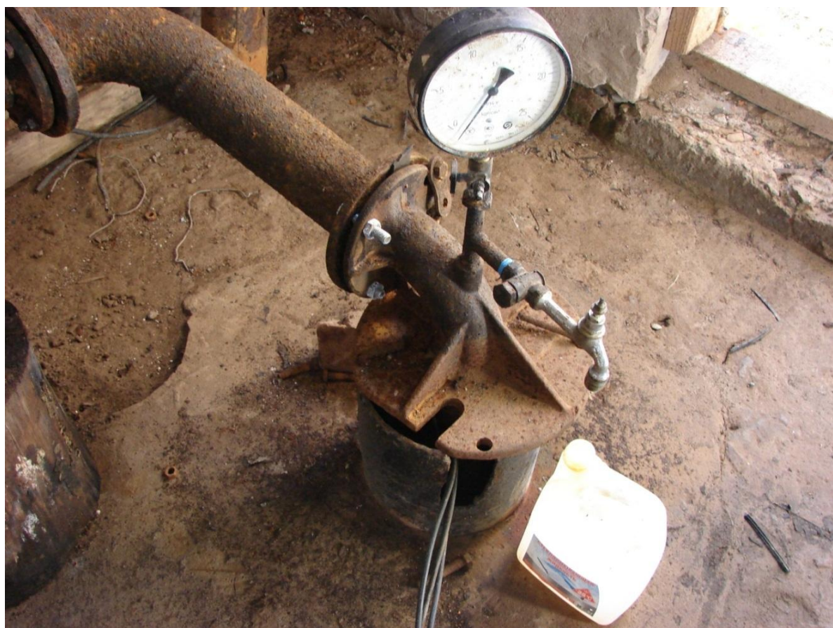
Рисунок 2. Оборудование в здании скважины.
