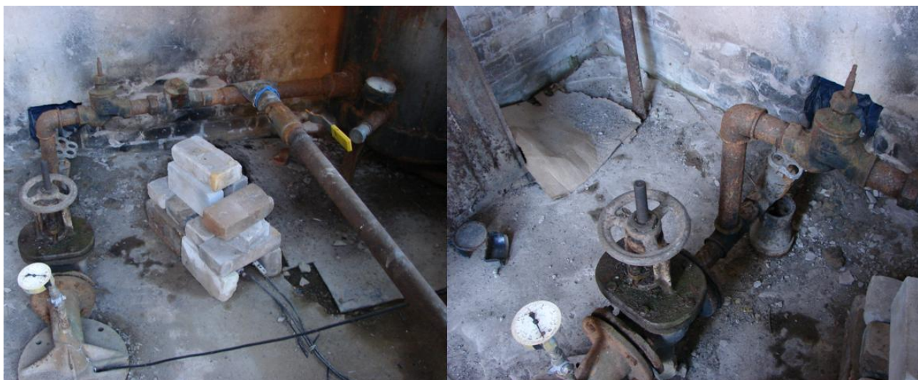
Рисунок 8. Оборудование внутри здания скважины (Колодриво)
