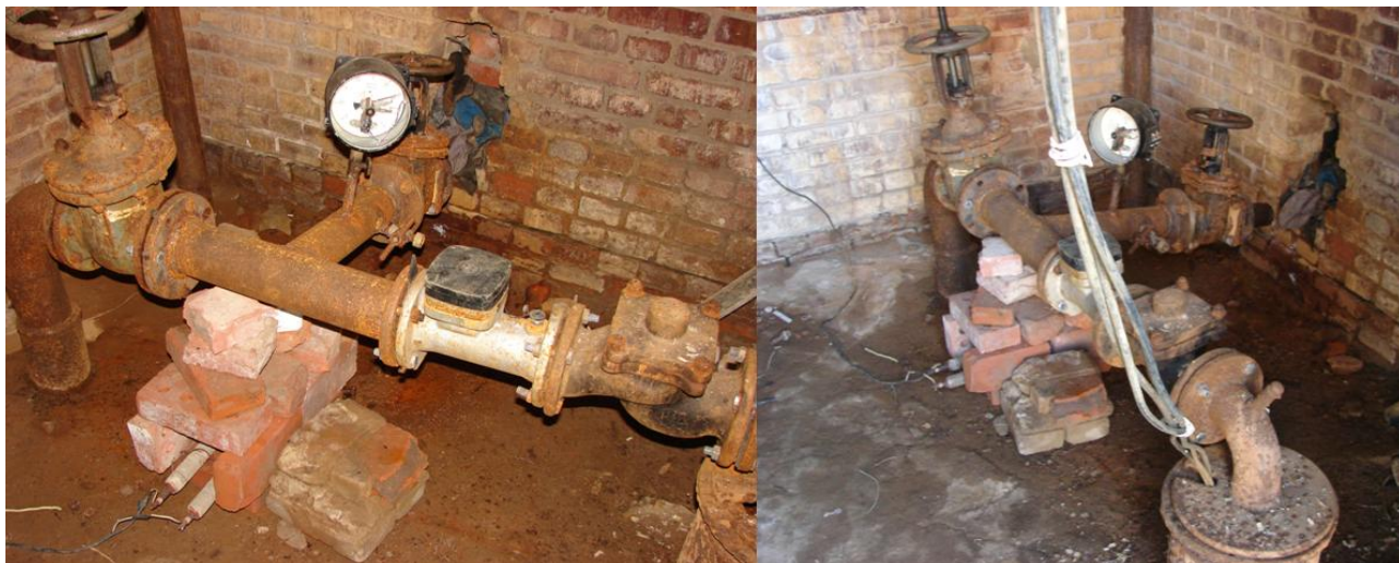
Рисунок 5. Состояние оборудования в здании скважины (Овсище)
